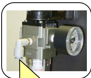
1次側エア配管
